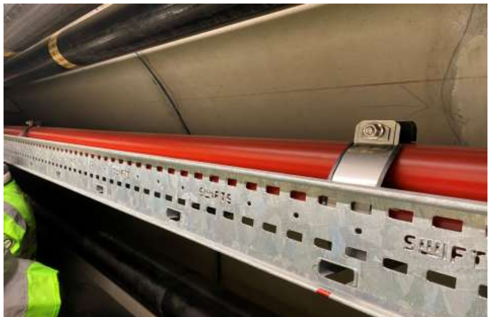
Alle stroom van windmolens HW-Zuid gaat door deze ene rode kabel...
